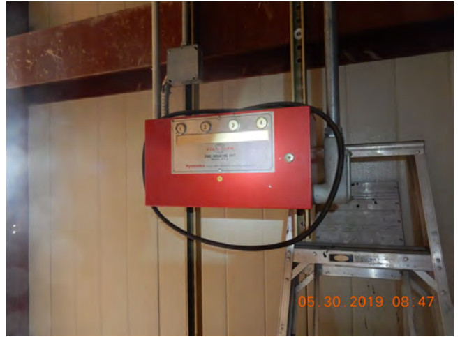
134. Fire alarm annunciator
